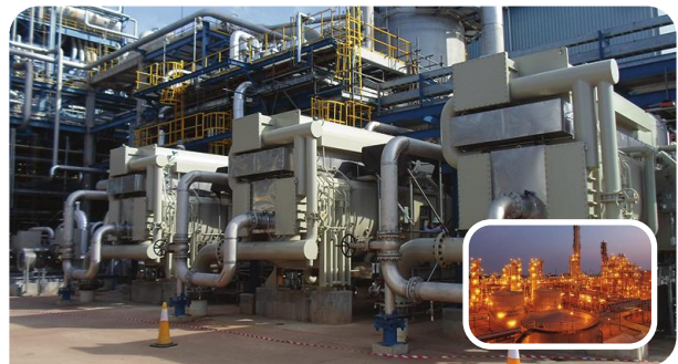
태국 TOC Glycol 저온수 흡수냉동기 270usRT
