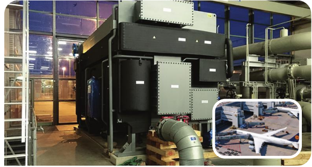
독일 Munich International Airport 저온수2단 흡수냉동기 975usRT
