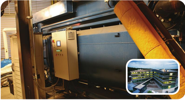
독일 IBM Ehingen 저온수2단 흡수냉동기 206usRT
