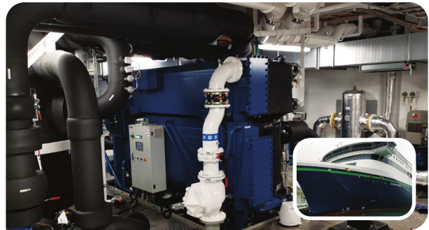
독일 Niederegger Lubeck 선박용 저온수 흡수냉동기 78usRT
