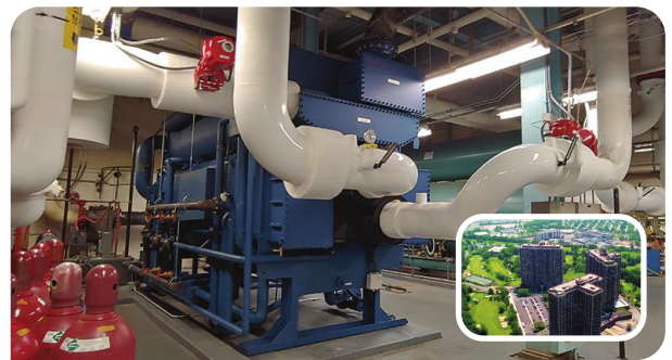
미국 North Shore Towers 증기식 1중효용 흡수냉동기 1,400usRT
