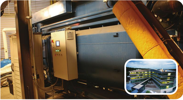
독일 IBM Ehingen 저온수2단 흡수냉동기 206usRT
