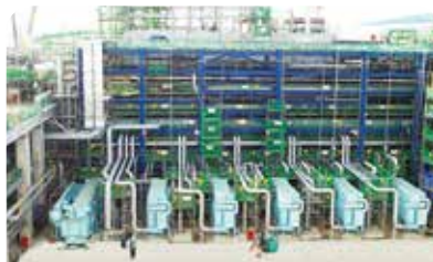
삼성토탈 증기식 2중효용 흡수냉동기, 저온수 흡수냉동기 6대 총 9,789usRT
