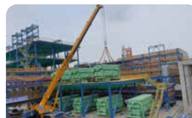
대산 현대케미칼 HPC 저온수 흡수냉동기 4대 총 6,000usRT, 증기식 2중효용 흡수냉동기 3대 총 6,000usRT
