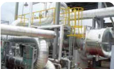
여수 금호폴리캠 폐열회수설비(MVR) 증기용량 5ton/h
