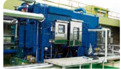
고려아연 정류기실 냉방설비 시스템 폐열회수 흡수냉동기 210usRT, 공기조화기, 냉수탱크, 덕트시설
