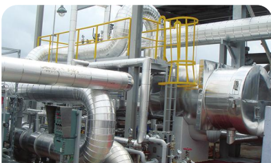
여수 금호폴리캠 폐열회수설비(MVR) 증기용량 5ton/h
