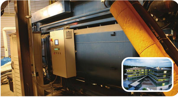
독일 IBM Ehingen 저온수2단 흡수냉동기 206usRT
