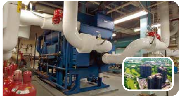
미국 North Shore Towers 증기식 1중효용 흡수냉동기 1,400usRT
