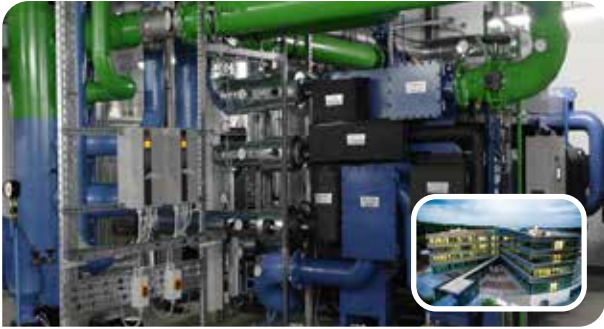
독일 IBM Ehingen 저온수 2단 흡수냉동기 206usRT
