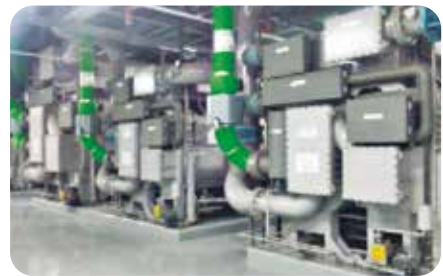
참고U SPACE 저온수2단흡수냉동기 설치
