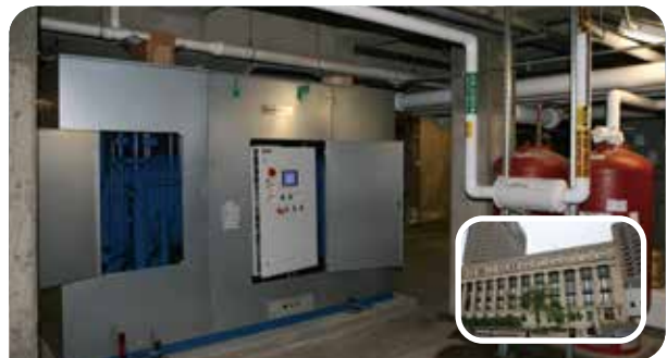
미국 New Haven Hall of Records 저온수 흡수냉동기 50usRT
